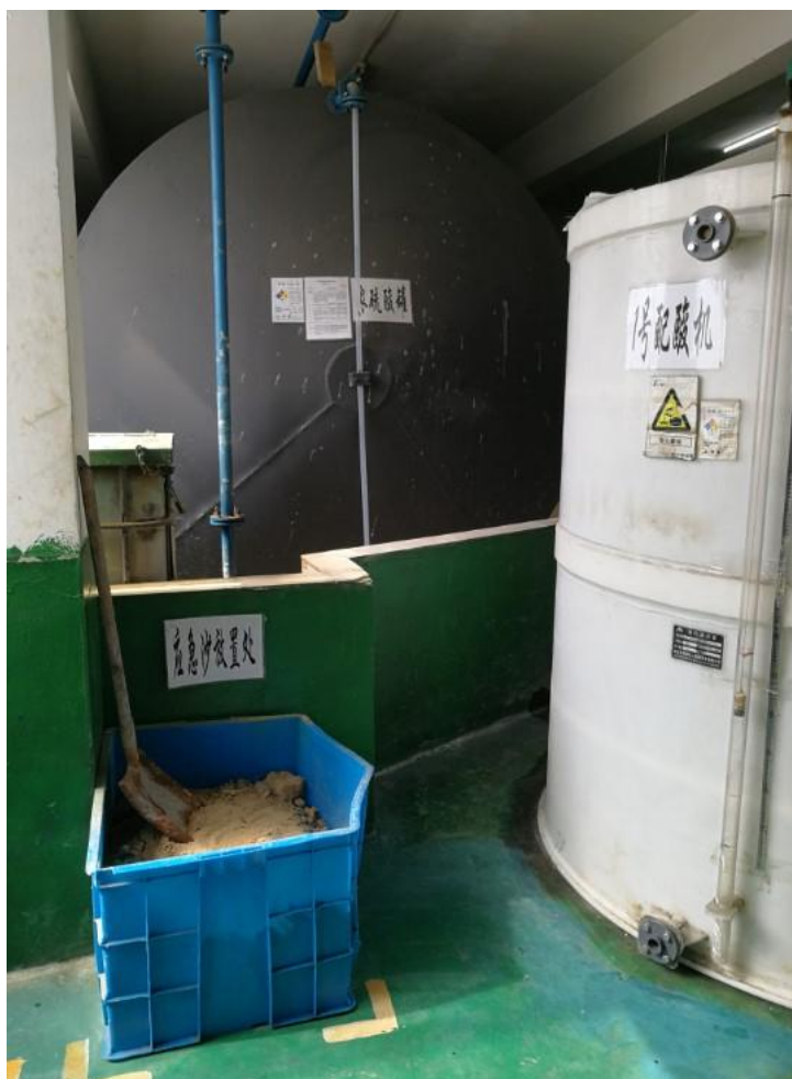
图 4.1-1 硫酸储罐区现场照片
