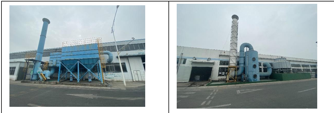
图 8.2-1 排气筒及废气处理设施现场照片
